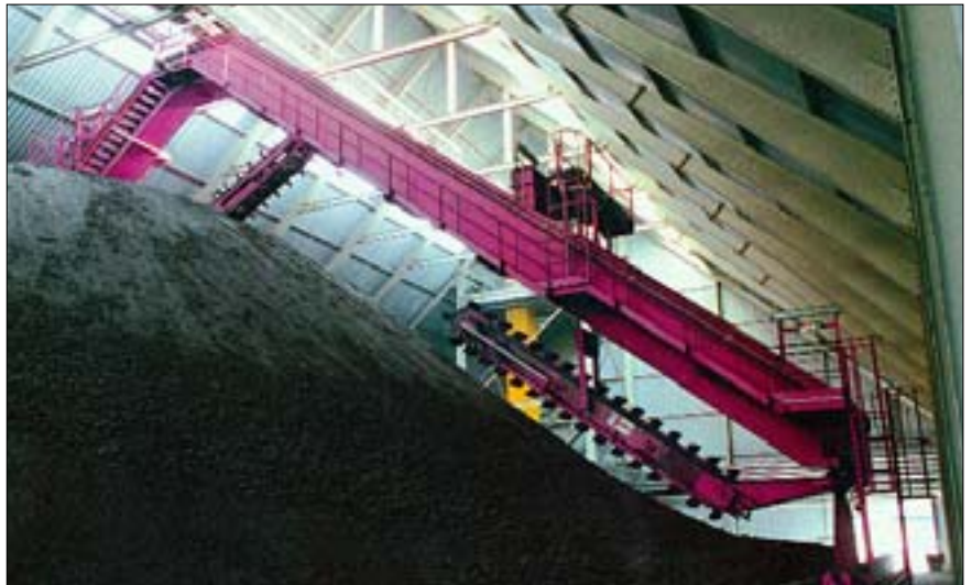
Equipo de recuperación de pórtico, carbón
