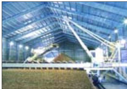
Equipo de recuperación lateral, pizarra
