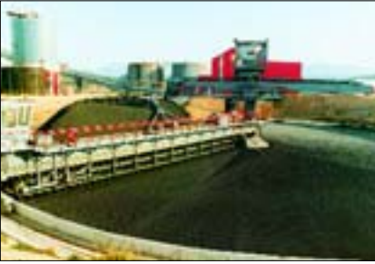
Parque de almacenamiento circular, carbón
