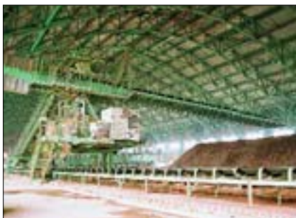
Apilador de caliza en una fábrica de cemento
