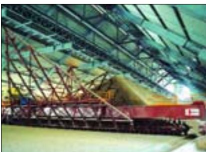
Recuperador de puente para calizas (planta de fabricación de cemento)
