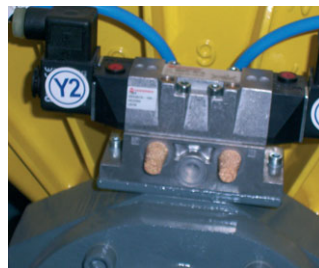
Magnetventile für Zwischenstellungen der Walze
