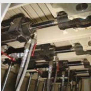
Sistema de accionamiento hidráulico.
