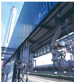
Estación de descarga de caliza.
