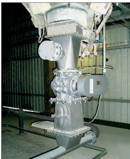
Sistema de transporte FLUIDCON en la planta E-on Farge
