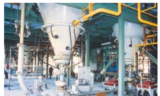
Sistema de inyección de carbón pulverizado.
