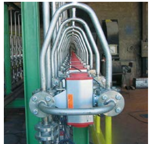
Sistema de control de gas para oxígeno.
