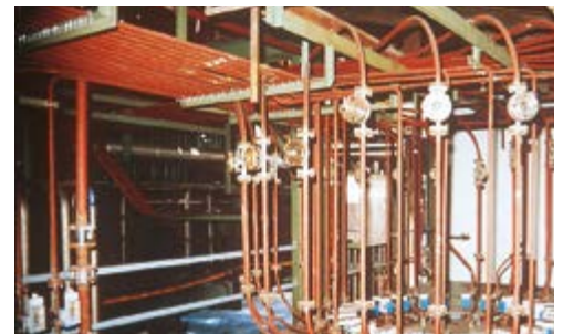
Distribuidor de carbón con válvulas individuales.
