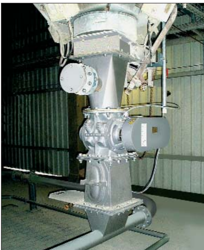
Système de transport FLUIDCON à l'usine E-on Farge
