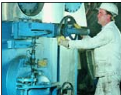
Boîte de collecte des refus isolée des gaz chauds.
