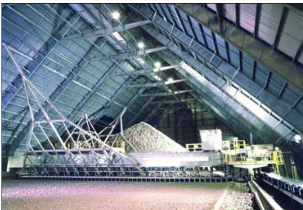
Parc de préhomogénéisation : gratteur pont
