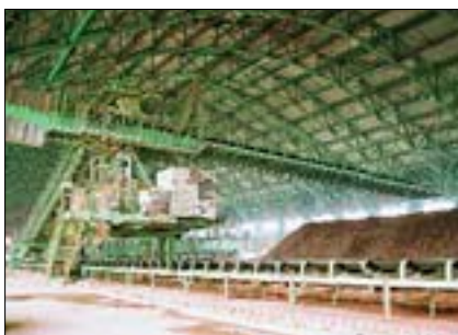
Stacker calcaire en cimenterie
