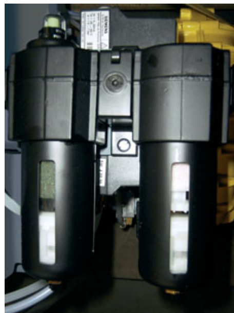
Maintenance préventive par utilité de conditionnement d'air autonome
