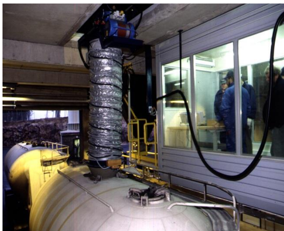
Poste de chargement stationnaire
