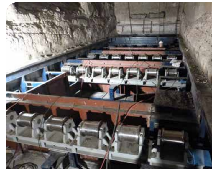
Figura 4. Resfriador preparado para instalação das fileiras
