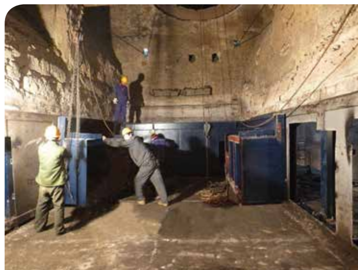
Figura 2. Posicionamento da ventilação lateral
