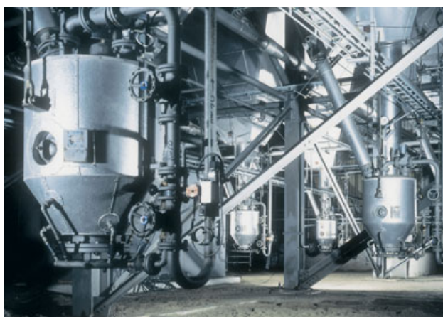
Транспортировка золы уноса из-под электрофильтра при помощи пневмокамерных насосов
