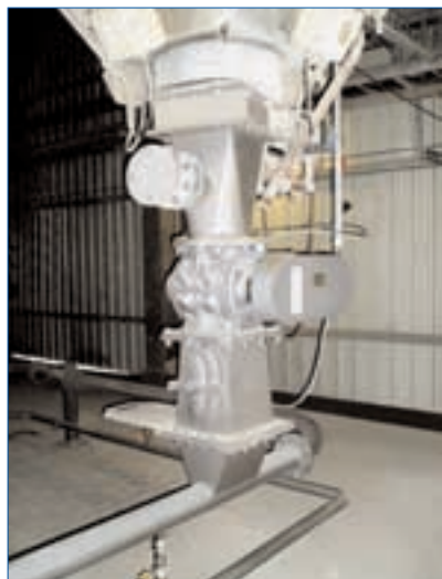
Транспортная система FLUIDCON на электростанции E-on Farge, Германия
