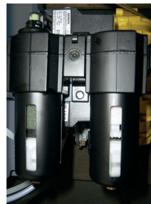
Профилактическое обслуживание с помощью блока кондиционирования воздуха
