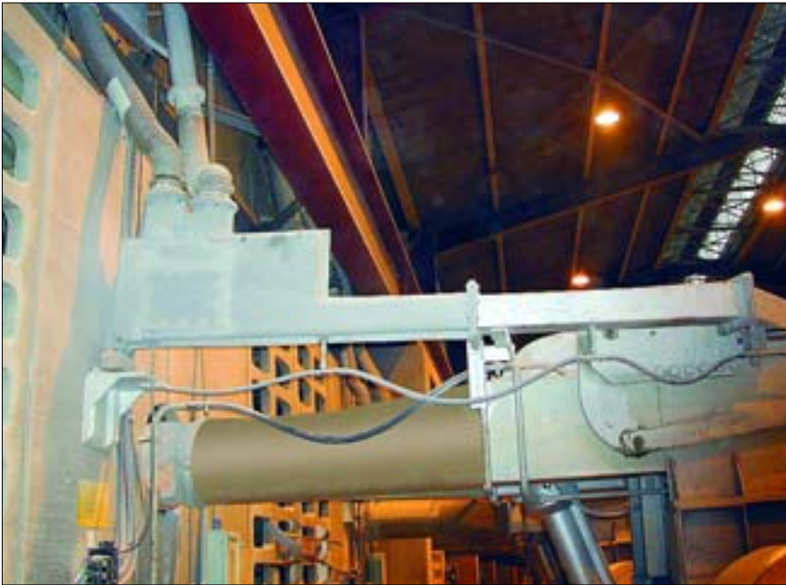
Aluminiumoxid- und Fluoridbeschickung in fester Verbindung zur Elektrolysezelle: staubdicht
